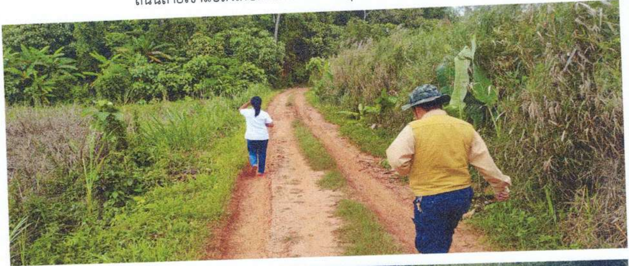
ภาพถ่ายสำรวจถนนลงหินคลุก หมู่ 2 บ้านดอกจําปี ตำบลเขาค้อ อำเภอเขาค้อ จังหวัดเพชรบูรณ์ ถนนสายเข้าแปลงเกษตรสายสปินเวย์ จุดที่ 2 ก่อนดำเนินการ
